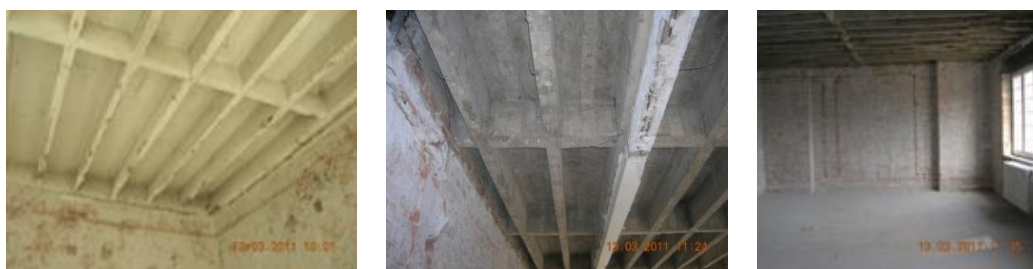
Slika 10- Izgled konstruktivnih elemenata međuspratne tavanicekoji se saniraju
