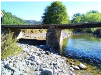
c) Damage to the middle pillar/ Oštećenje srednjeg stuba
