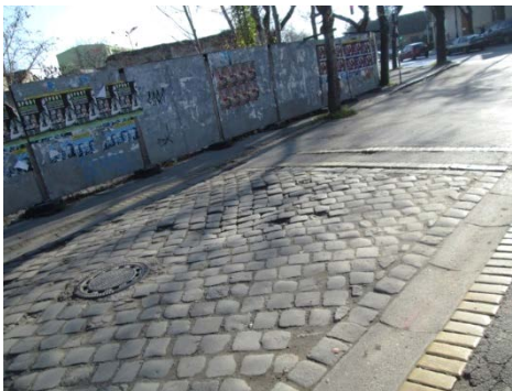
Slika 8. Kraj kaldrmisanog dela ulice i ulegnuće na kolovoznoj površini
