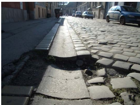
Slika 7. Nefunkcionalni elementi za odvođenje atmosferske vode
