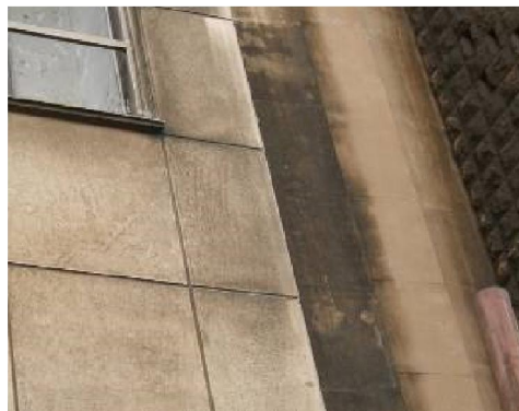
Slika 5 – Zaprlijana obloga fasade od „Veselja“ na objektu B
