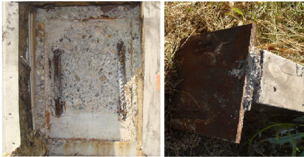
Слика 1. Хаварија затегнутог склопа анкер-анкерна плоча (деталј анкер плоче)
