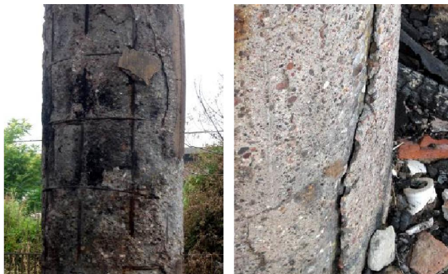
Slika 2. - Oštećenje zaštitnog sloja, armature i "jezgra" betona i vertikalna prslina
